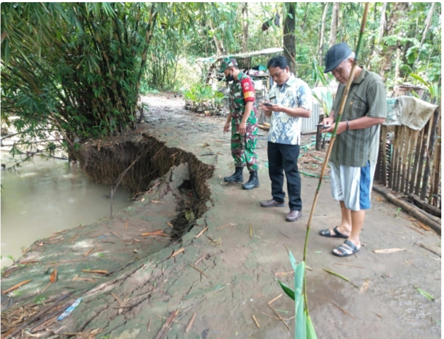
Serda Nur Arifin cek Lokasi tanggul sungai Sirago Amblas di wilayah Dusun Ingas RT 02/05 Desa Sruweng
